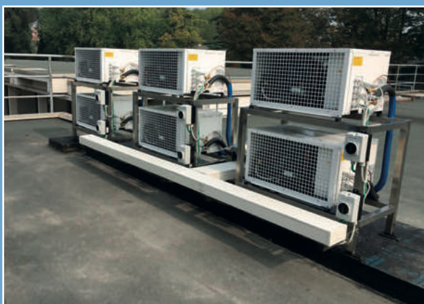
Unità refrigerante remota posizionata su struttura inox / Remote cooling unit positioned on a stainless steel frame
