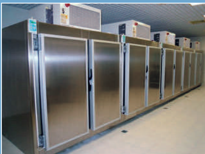
Gruppo celle frigorifero con più impianti monoblocco a soffitto / Group of mortuary refrigerators with several top mounted monoblock units
