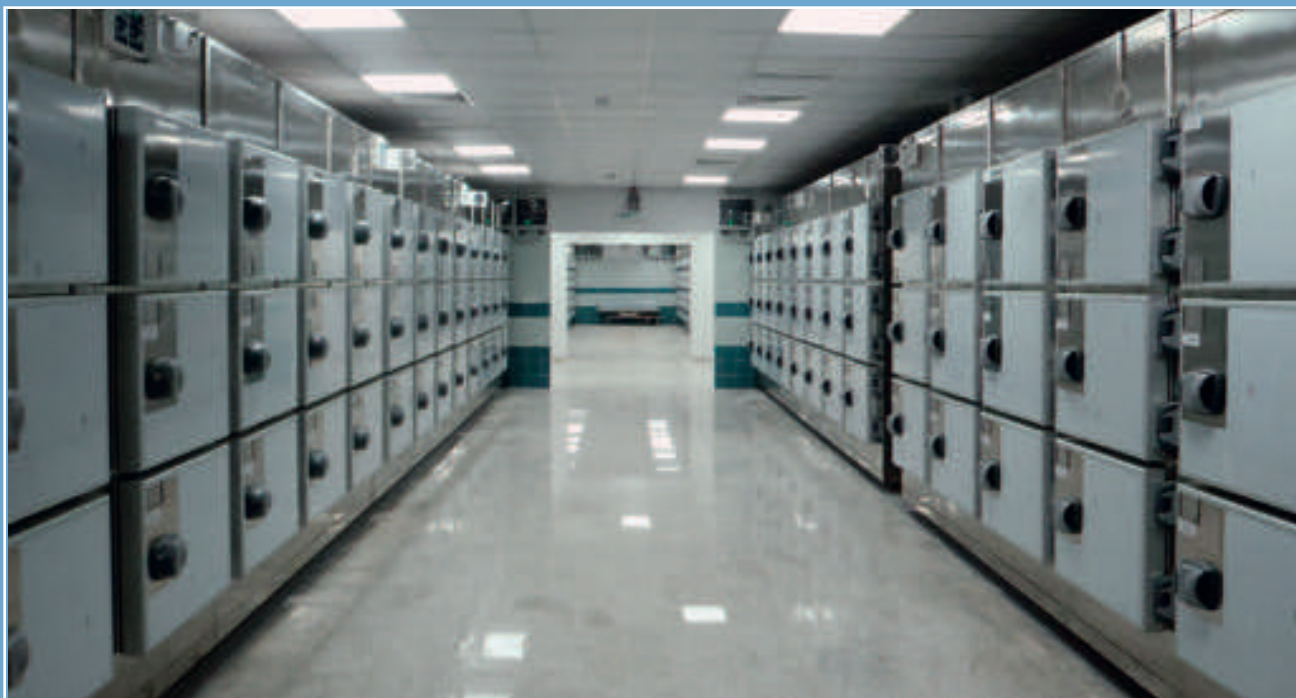
Gruppo di celle frigorifero 12 posti, 12 sportelli / Group of mortuary refrigerators 12 bodies, 12 doors
